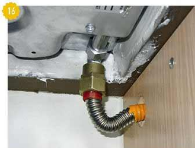
16 Подключение газовой варочной панели к внутреннему газопроводу.
