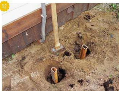
12 Забитые в грунт трубы станут частью фундамента и одновременно заземлением для шкафа.
