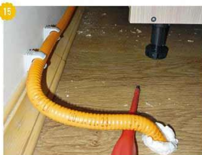
15 Ввод газопровода в дом и прокладка по стене. Использована сильфонная газовая труба Kofulso в полимерной оболочке.
