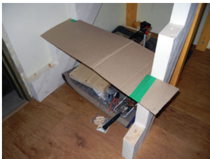
Шаблоны для ступеней, выкроенные в соответствии с проектом лестницы, примерили и подогнали по месту...
