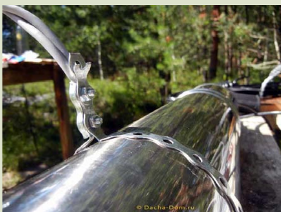
Фотографии №4 и №5. Подвеска погружного насоса в колодце.
