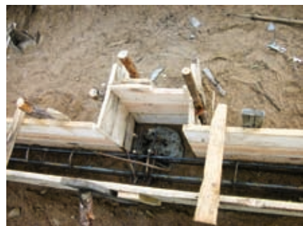
↑ Неправильное взаимное положение балки и опоры. Арматурный каркас ростверка не лежит на опорной буровой свае.
