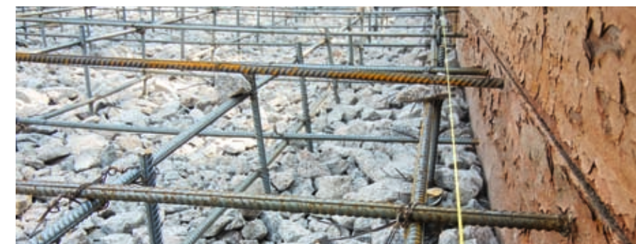
↑ Недостаточный защитный слой бетона. При изготовлении фундамента-плиты допущены ошибки: нет защитного слоя бетона внизу и отсутствует торцевая анкерка арматурного каркаса П-образными элементами.
