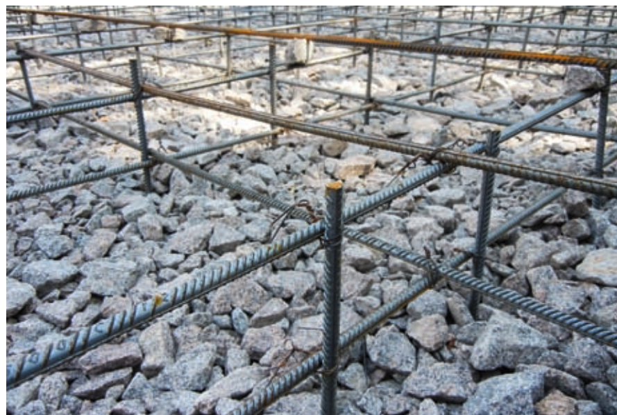
↑ Ошибка армирования фундамента плиты. Стержни монтажной арматуры воткнуты в грунт и будут оставлены в таком положении при укладке бетонной смеси. Стержни будут служить проводниками гальванических токов и приведут к ускоренной коррозии арматурного каркаса фундамента.
