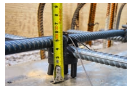
↑ Нижняя часть фундамента. Защитный слой бетона в фундаменте на бетонной подготовке равен 4 см.
