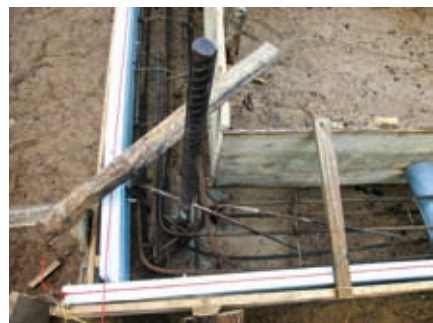
↑ Неправильное армирование угла ленточного фундамента. Вместо выполнения требуемой анкеровки стержней отгибом под углом 90 градусов или использования П-образных элементов стержни арматуры просто загнуты.
