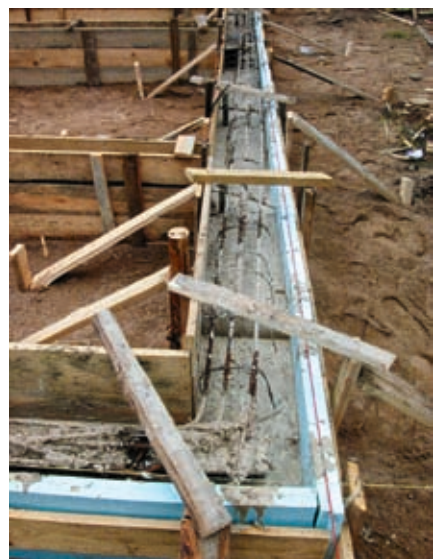
↑ Пример некачественной вязки арматурного каркаса. Нарушено проектное положение стержней и увеличен защитный слой бетона.
