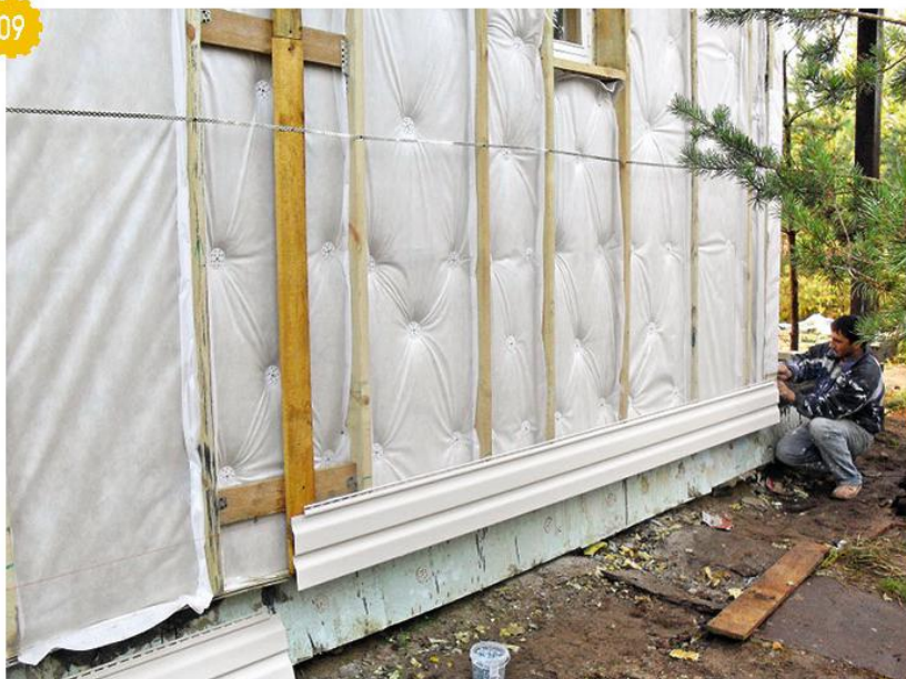
Монтаж сайдинга по нестандартной технологии без доборных элементов. Под место стыков панелей пришлось установить опорную доску.
